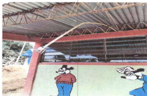
Foto 8: En esta fotografía se muestra como el sistema electrico esta en malas condiciones
