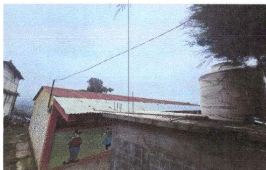
Foto 2: En esta imagen se visualiza que en un lado del techo ya esta muy oxidado
