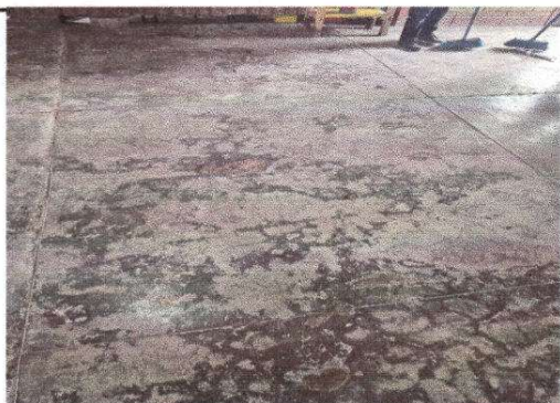
Foto 3: Aula 1 de segundo y tercero ya tiene varios agujeros el piso
