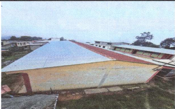
Foto1: En la imagen se visualiza que el techo esta en malas condiciones y esto provoca que ingrese agua a las aulas
