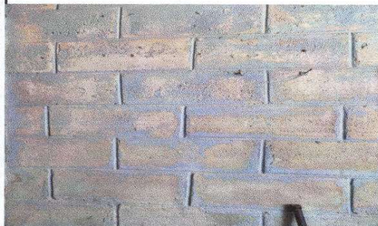
Foto7: En esta fotografía se evidencia que la pintura del establecimiento ya esta en mal estado
